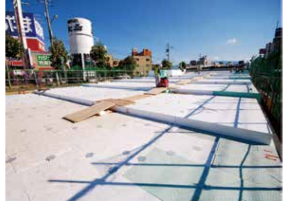
橋台・地覆部は景観を考慮して目地模様を統一
